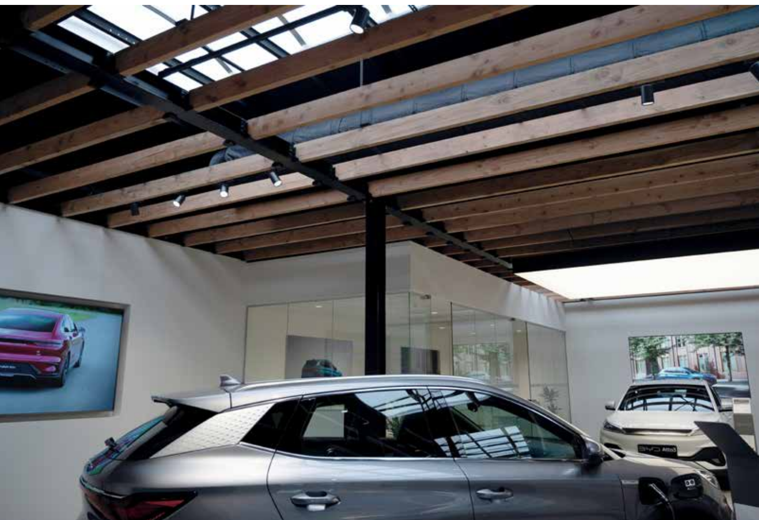
De zwarte Prihoda textielkanalen gaan onopvallend op in de plafondconstructie.
